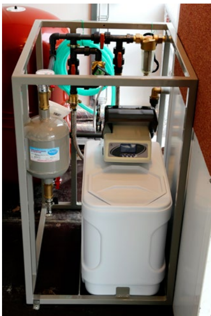
Устройство подготовки воды
