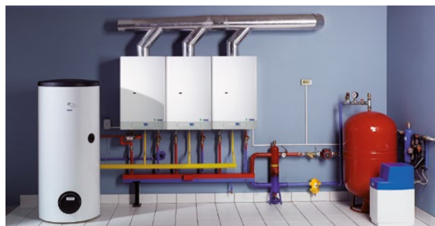
Котельная с тремя котлами THERM DUO 50.A
