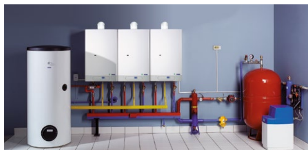
Котельная с тремя котлами THERM DUO 50 FT.A
