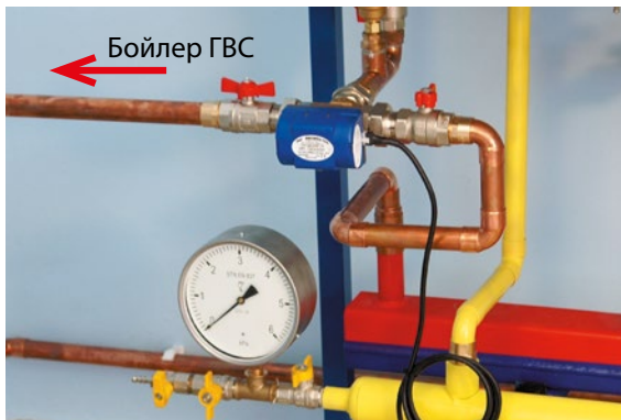
Подсоединение бойлера ГВС к котлу
